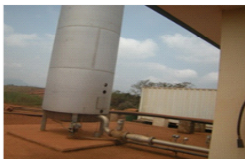
Photo 8 : centrale de brûlage du biogaz (Nkolfoulou)
